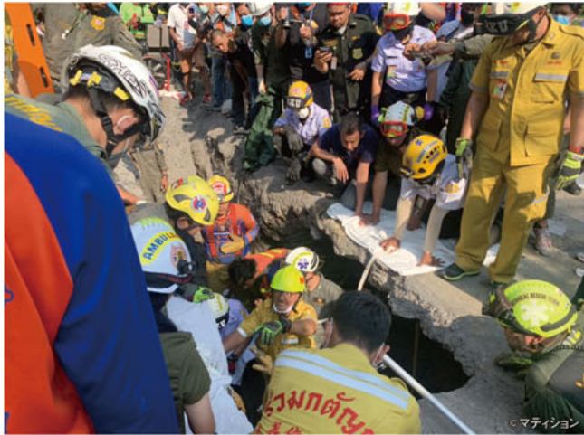
エカマイ・ソイ2の入口で6日、工事中に地盤沈下が発生。作業員1名が死亡した
