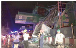
事故が発生した現場の様子。負傷者の救助と共に、落下した橋脚が交通を妨げないように警察が迅速に対応した
