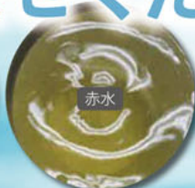
水道管の赤錆
